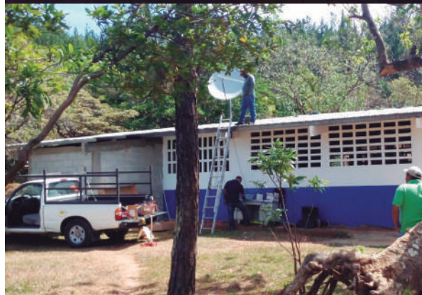
Sistema Fotovoltaico en el C. E. B. G. El Paredón, Región Educativa de Veraguas.
