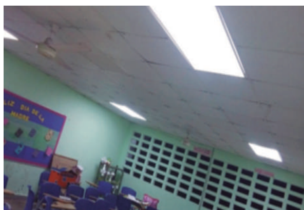
Iluminación de los salones en el Centro Educativo Cémaco.
