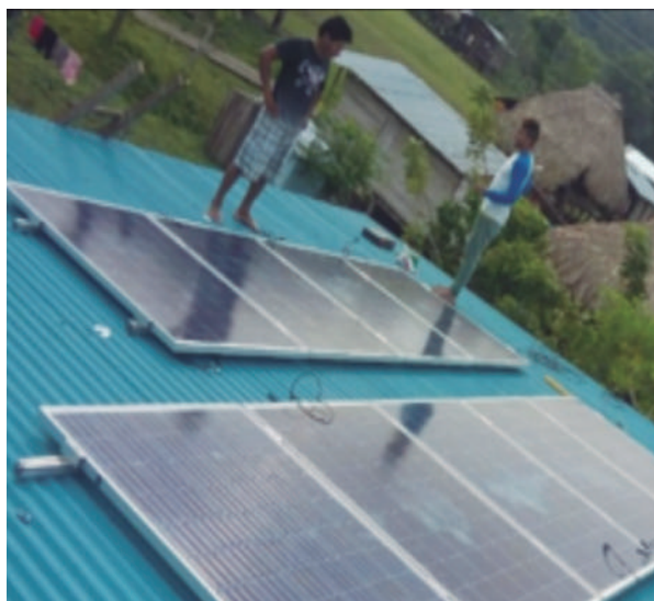
Paneles solares instalados en el Centro Educativo Cémaco.
